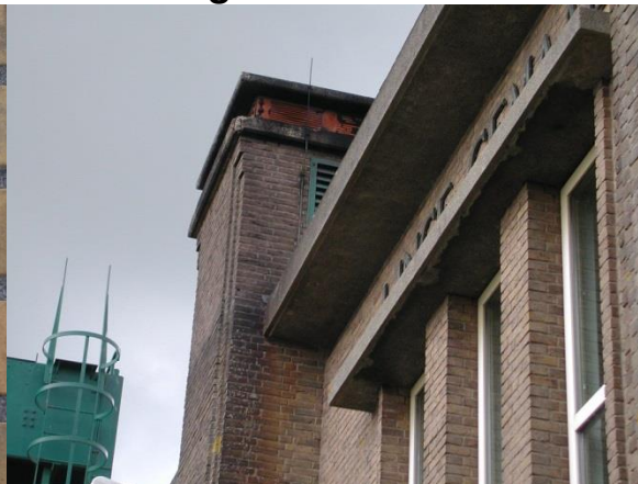
Vervuiling door roet (2.3.b)
