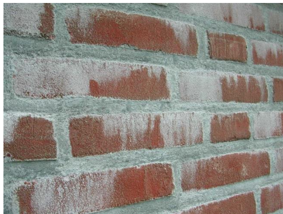
Uitspoelen van kalk uit vers voegwerk (2.1.b)
