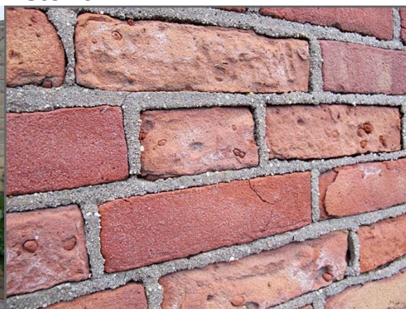
Schade aan metselwerk door binnengedrongen zeezout (2.1.a)
